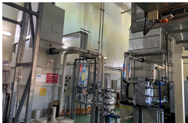
Nhà máy gelatine – cụm thiết bị sấy và hệ ống hơi, chế tạo tại Hà Lan, sau lắp đặt. Ảnh tư liệu Kim Nguyễn.
